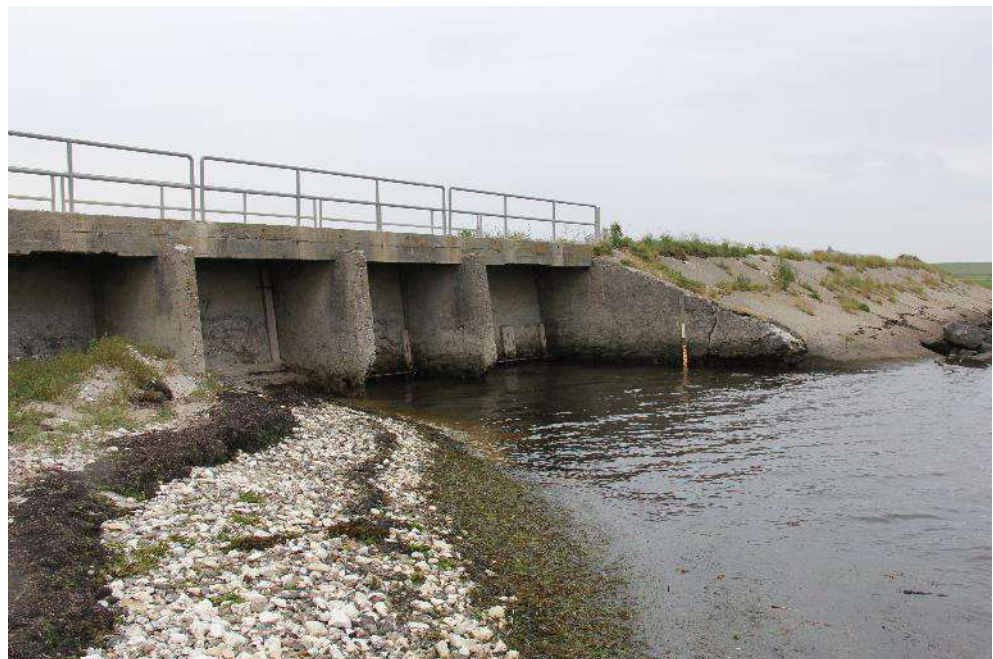
Figur 57: Arup Sluse med Limfjorden i forgrunden. Udløbet fra Tømmerby Å sker gennem tophængte højvandsklapper.
